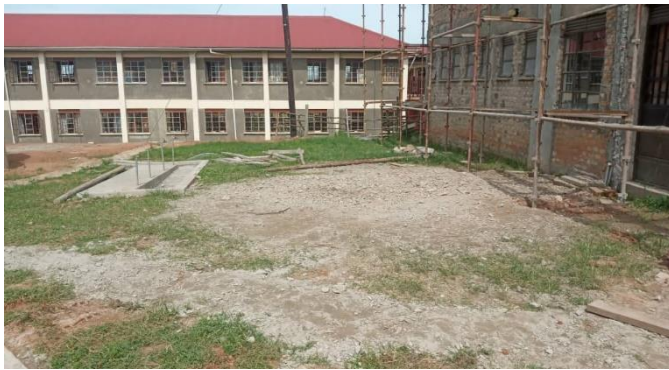
Foto 8: De grond nabij de kranen moet nog worden gecementeerd zodat het gebruikte water wegloopt en in een afvoer achter de ondergrondse tank terechtkomt.
