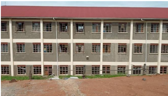
Foto 2: Zij-aanzicht van een van de twee gebouwen met klaslokalen. De leidingen die het regenwater van het dak afvoeren, komen samen op grondniveau en gaan ondergronds naar de ondergronds tank.
