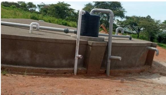
Foto 3: Filtertank: De leidingen van het slaapgebouw en die van het gebouw met de leslokalen komen hier uit de grond en voeren het water naar een kleine filtertank. Deze filtertank voorkomt dat het stof, dat zich tijdens de droge seizoenen op de daken verzamelt, in de ondergrondse opslagtank terecht komt.
