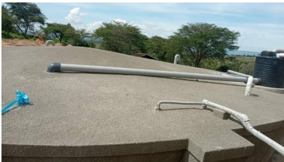
Foto 4: Na te zijn gefilterd gaat het water via een dikke leiding door het dak naar de ondergrondse tank.
